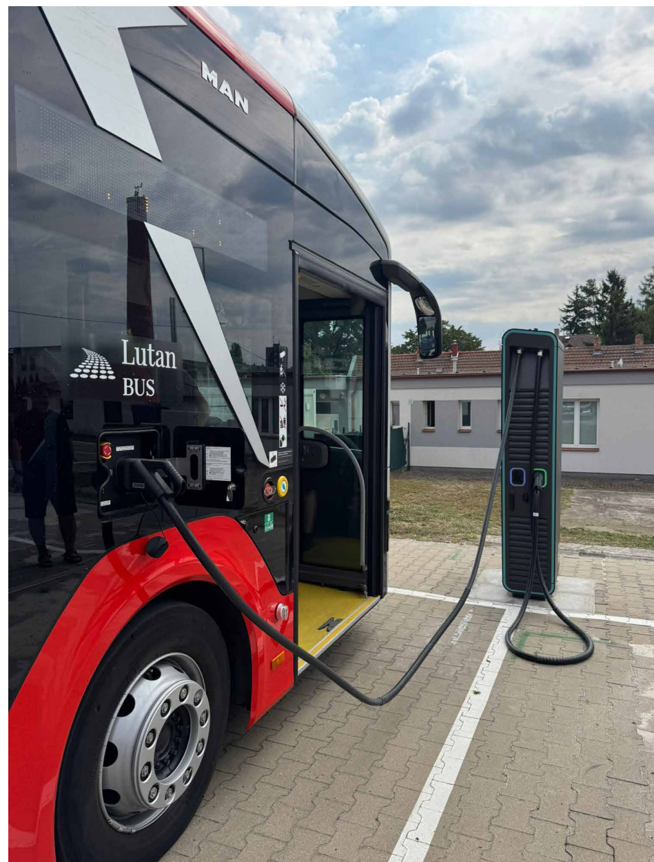
Dobíjecí infrastruktura MHD v Kutné Hoře
