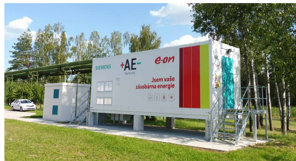
Bateriové úložiště Mydlovary
